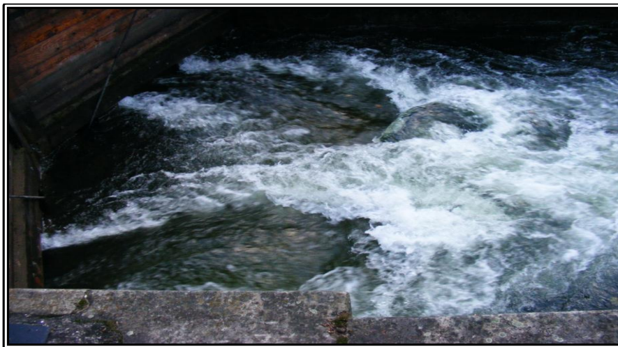
Fotografia 39 Pojezierze Suwalskie, śluza Przewieź , [fotogr. kol.], M. Litak
