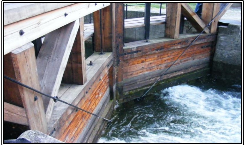
Fotografia 38 Pojezierze Suwalskie, śluza Przewieź , [fotogr. kol.], M. Litak
